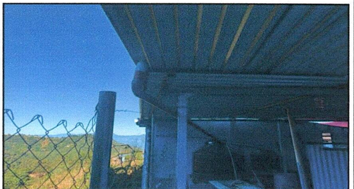
Foto 6: Caída de agua pluvial.
